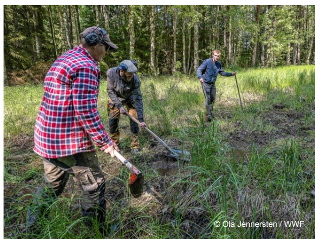
Vänta in rätt väder. Lagning av körskada efter blött väder.
